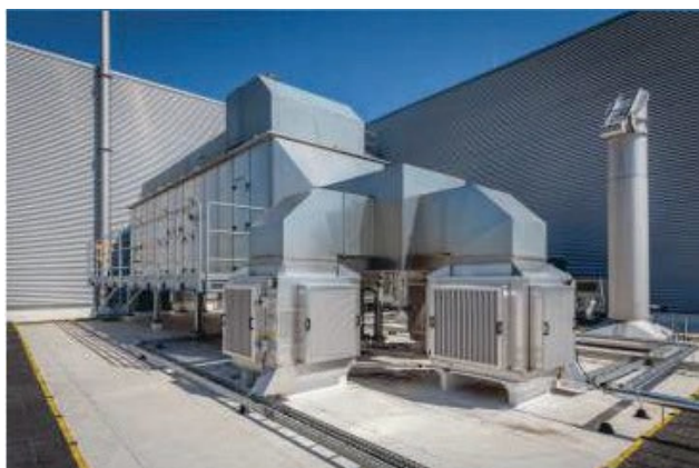
CoolStream V – jednostka pełniąca funkcję czepni powietrza dla istniejącej centrali wentylacyjnej
